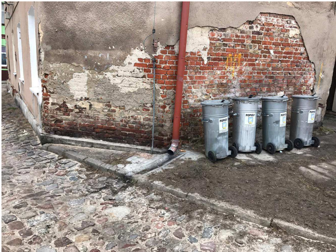
Widok naroża ściany od strony ul. Wąskiej – zawilgocenia ściany.
