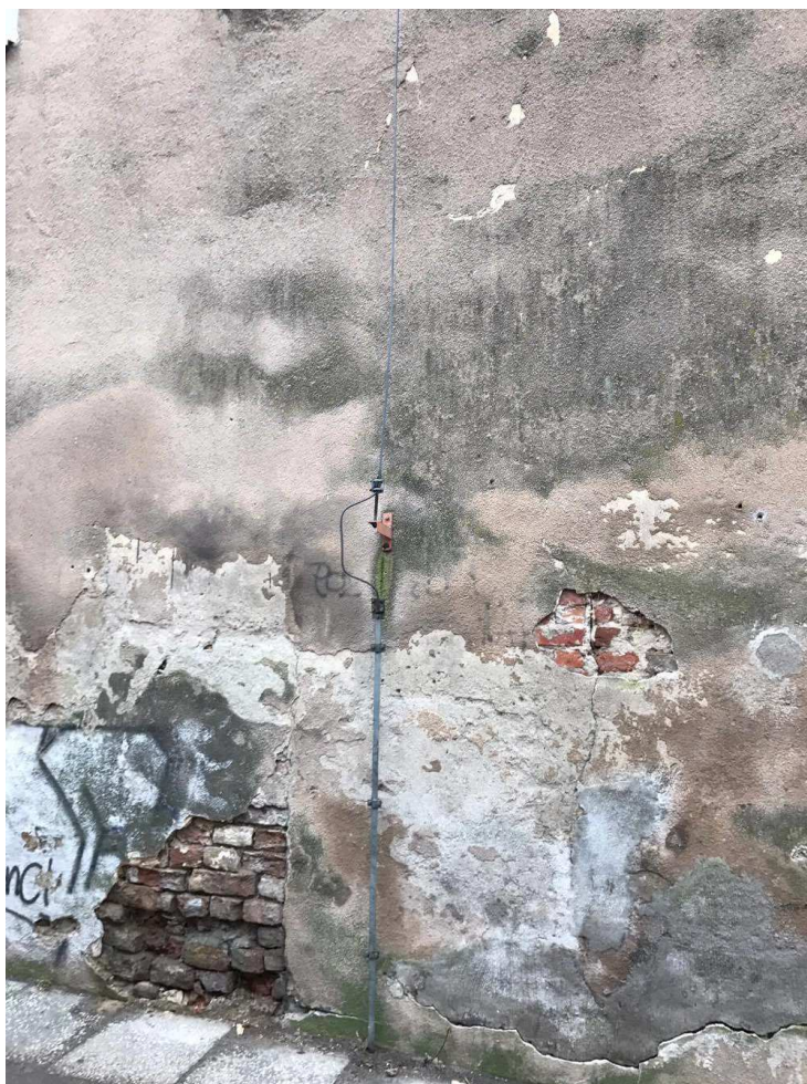
Widok ściany elewacji bocznej – ubytki cegieł.
