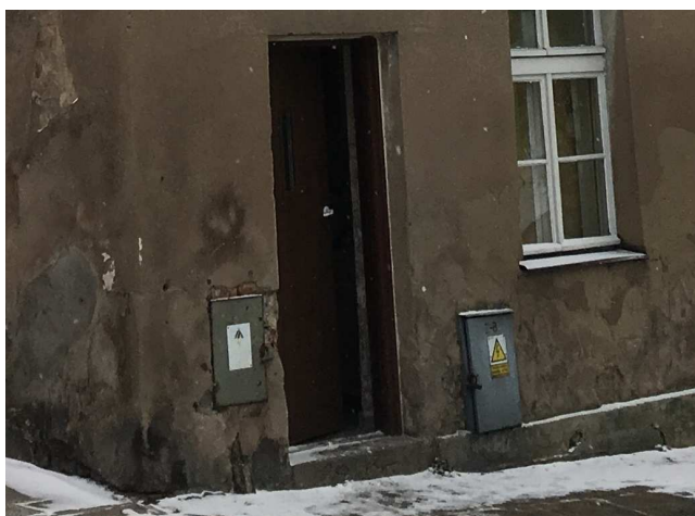
Widok wewnętrznych skrzynek.
