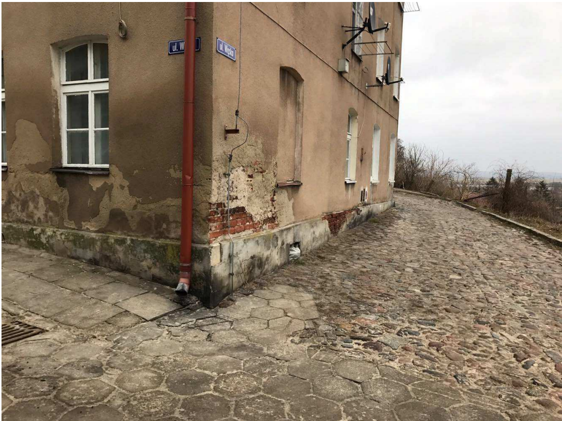
Widok naroża ściany od strony ul. Wodnej – zawilgocenie ścian
